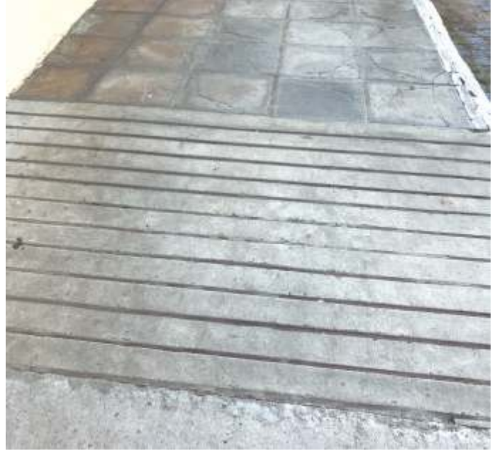
Foto 1: Pavimento de la rampa marcada en forma transversal y continua con líneas o canales.
